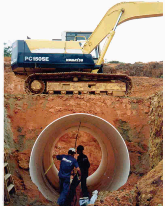
Figura 7 - Deformação sob carga
